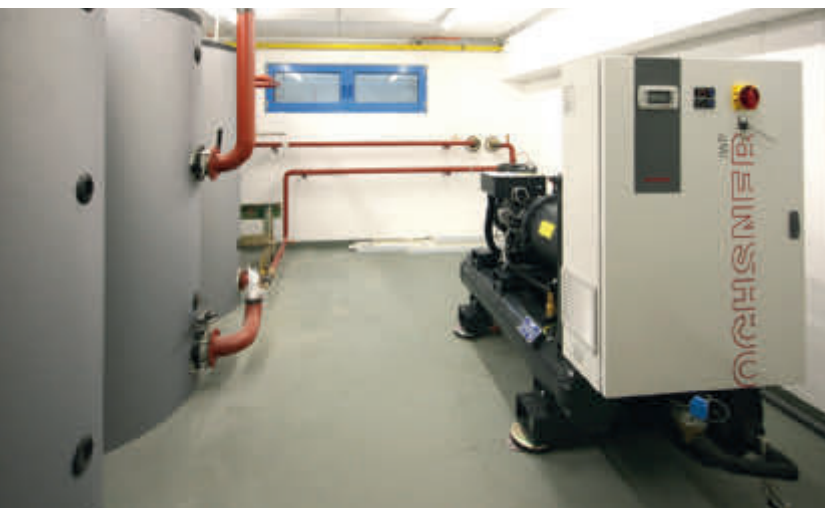
Abb. 12: Die OCHSNER Wärmepumpe IWWS210ER2 (hier im Bild während der Montage samt den Pufferspeichern) kann dank der hohen Abwassertemperaturen von ca. 22 °C äußerst effizient arbeiten.
