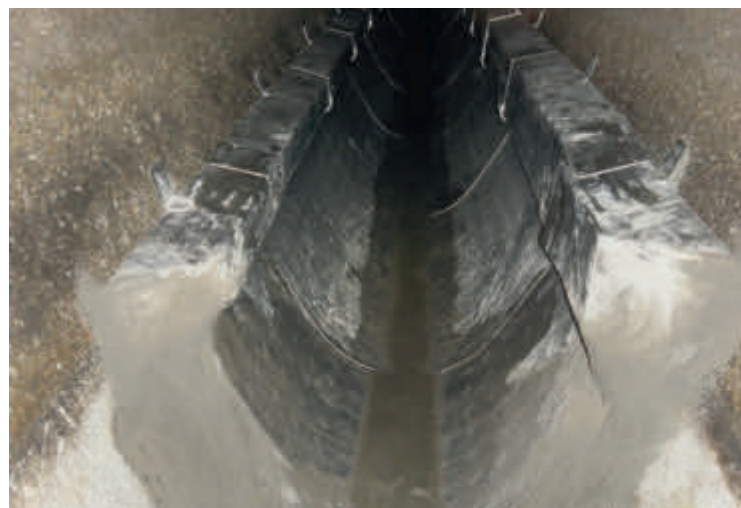
Abb. 13: Der Abwasserwärmetauscher „Thermliner“ der Anlage STADTwerke Amstetten (hier kurz nach Montage im Abwasserkanal) wurde in Absprache mit der Stadtentwässerung geplant und gebaut und erlaubt weiterhin einen störungsfreien Betrieb der Kanalisation.
