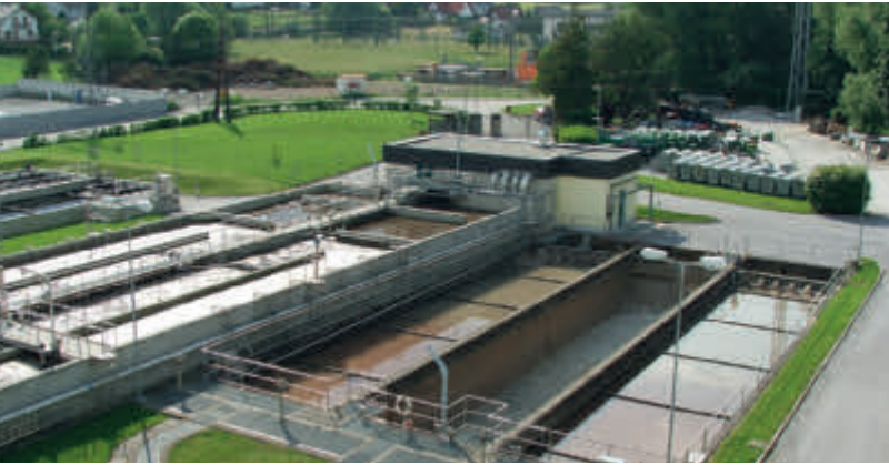
Abb. 6: In Weiz wird nach der Kläranlage Wärme gewonnen und damit zwei gewerbliche Betriebe beheizt. Mit der Anlage kann auch gekühlt werden.
