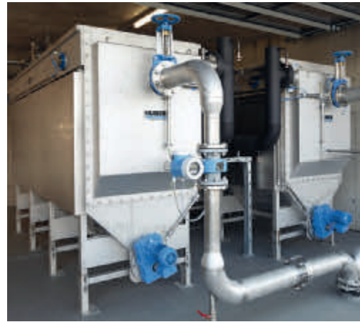
Abb. 8 links: In Straubing werden 11 Gebäude mit 102 Wohneinheiten zuverlässig mit Abwasserwärme beheizt.
