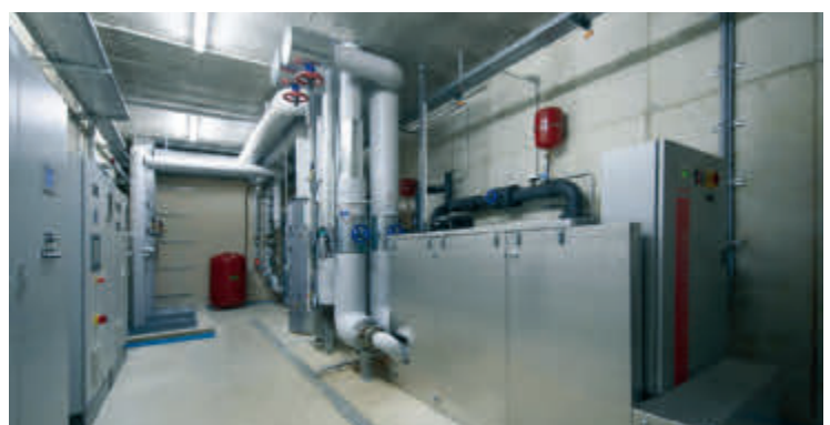
Abb.10: Blick in den Heizraum. Im Vordergrund WP OCHSNER ISWS150ER2 samt kompletter Schallschutzverkleidung.
