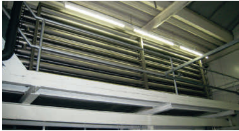
Abb. 7: Einer der beiden Abwasserwärmetauscher
