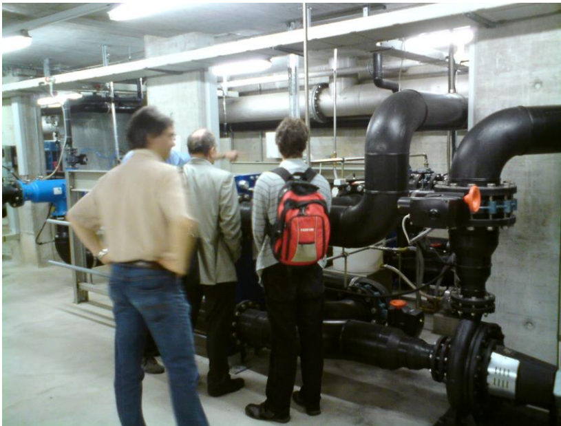
Abbildung 4: Wärmetauscheranlage im Gebäude der Kläranlage
