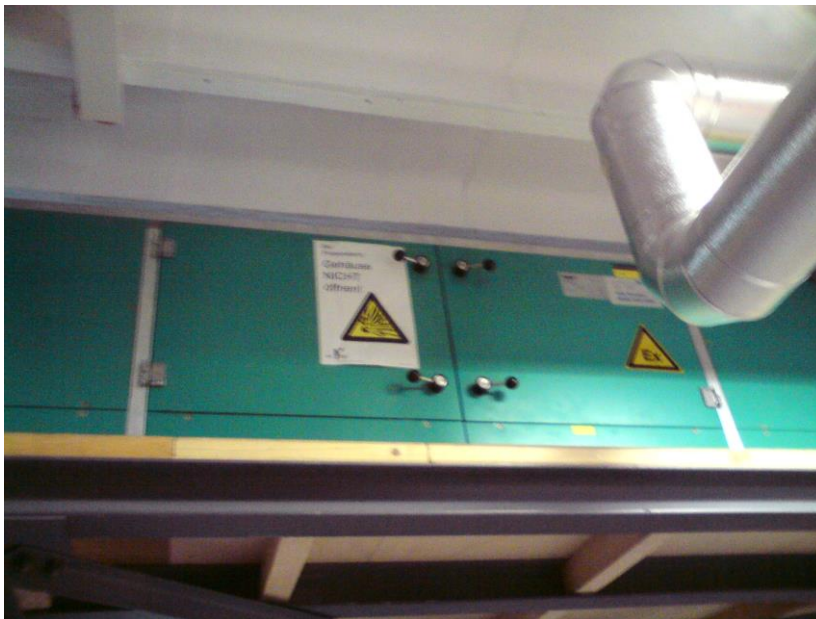
Abbildung 6: Wärmepumpe im Heizungskeller
